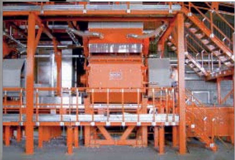
Herzstück der Anlage: der Nachzerkleinerer FineCut.
